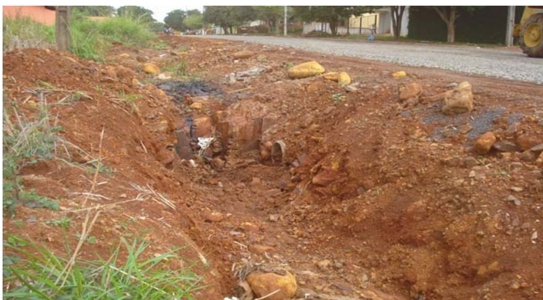
Figura 11. Processo erosivo linear situado nos setores de fundo de vale
