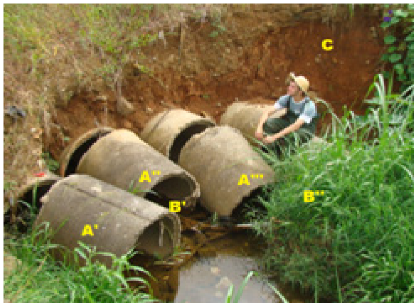
Figura 3. Seções fechadas com entulho e alteradas pela desestabilização do solo
