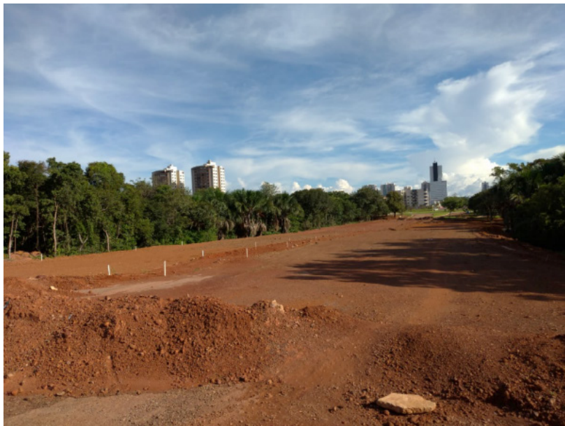
Figura 4 – Supressão vegetal e compactação do solo no Córrego Suçuapara no trecho da construção da ponte na Avenida NS-04.
