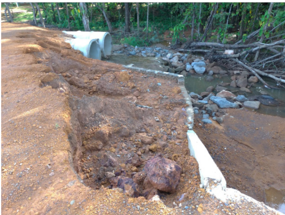
Figura 5– Erosões e assoreamento causados pelo sistema de drenagem instalado sobre o Córrego Suçuapara no trecho da construção da ponte da Avenida NS-04.
